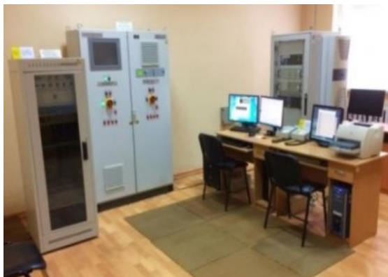
Рис. 1.43 – Зовнішній вигляд апаратного залу станції УНСП-8.2 [9]
