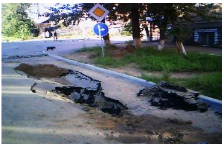
Рис. 2. Деформації поверхні при проведенні ГНБ в міських умовах.
